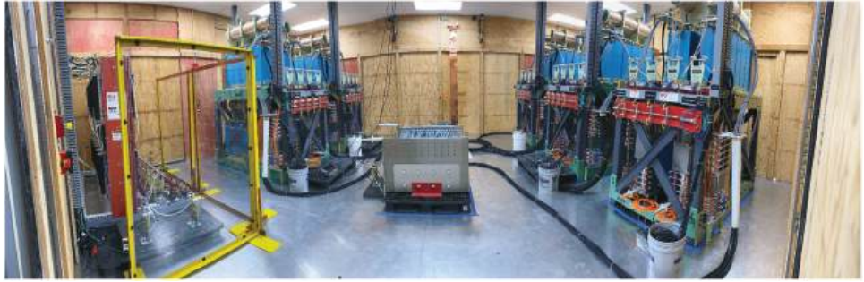
Fig. 4. Panorama of the 100kWPS-01 enclosure interior.
